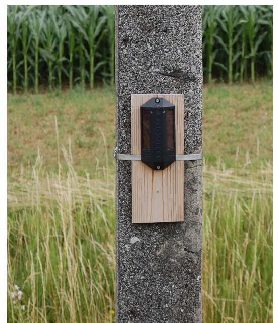
Das optisch-akustische Wildwarngerät ist entlang der Gleise an einem Masten montiert und löst bei Geräusch oder Scheinwerferlicht eines Zuges LEDs und einen Pfeifton aus. (©NB/Wegscheider)
